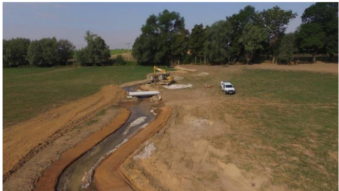
Figure 27 Création d'une rivière de contournement et reprise de l'ancien lit du ruisseau des Harpies en 2018
